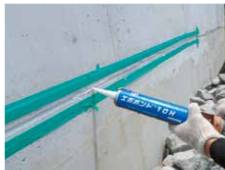
▲ひび割れへエポボンド1CHを使用
