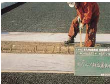
▲バックアップ設置状況
