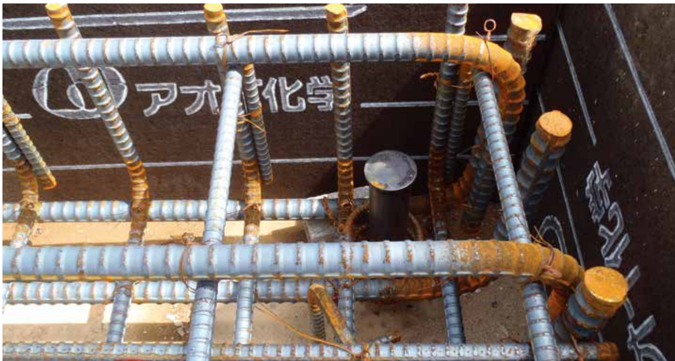
▲踏掛版アンカーの防食充填キャップに使用状況
