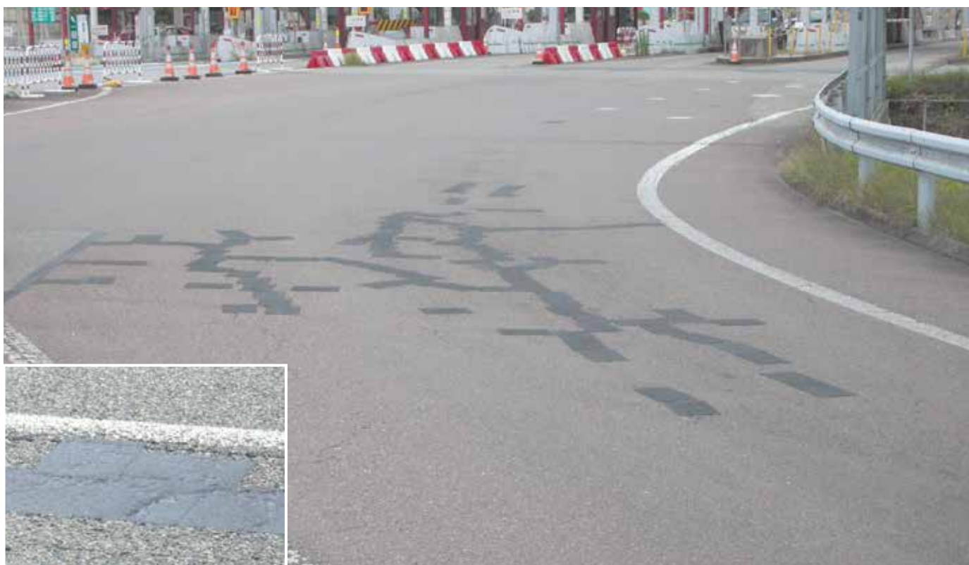
クラックへのなじみ状況
