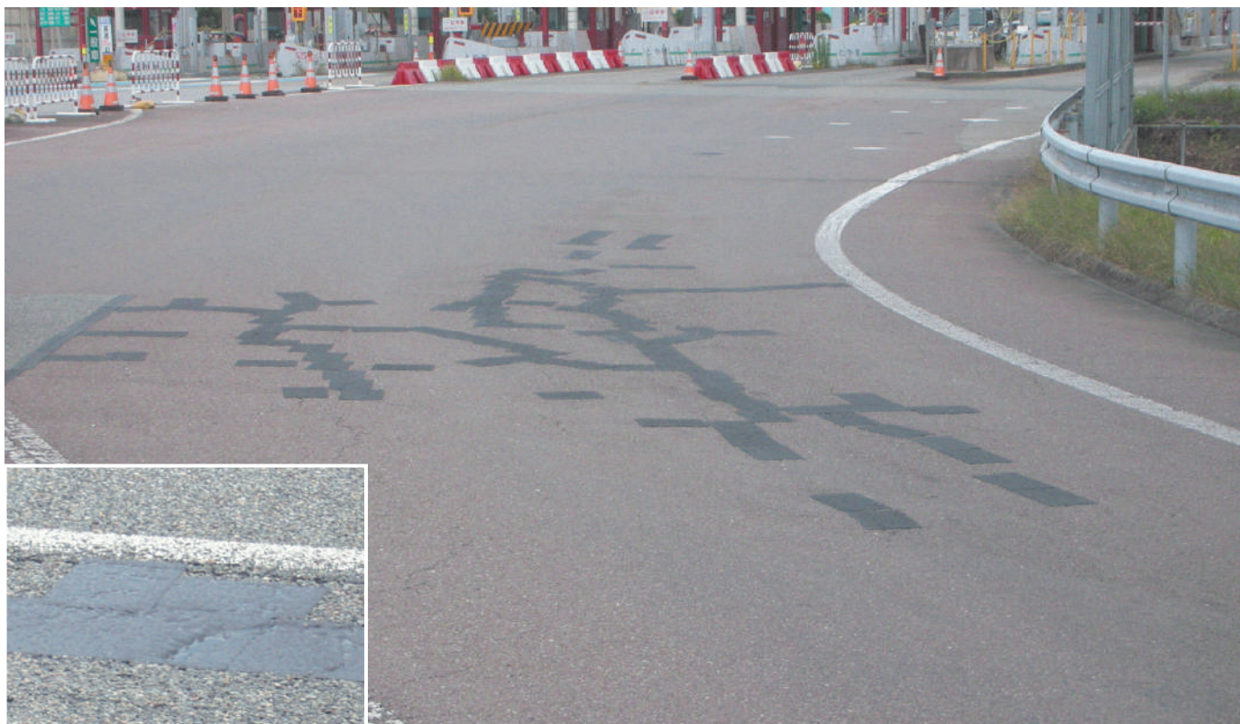
クラックへのなじみ状況
